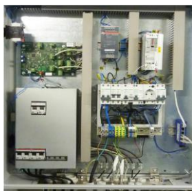
Armoire de pilotage
